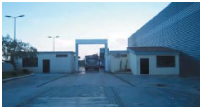
Arco de desinfección de vehículos situado en una planta de transformación de subproductos. Foto cortesía de ANAGRASA.
